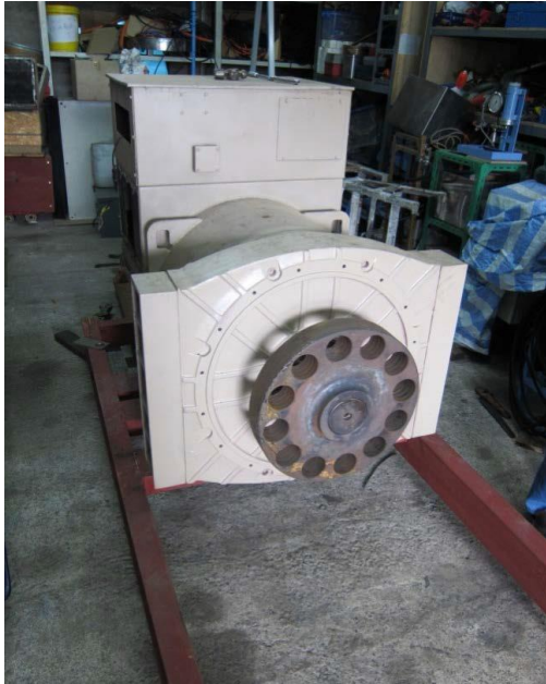
圖 4.11：交流發電機連機械接駁器
