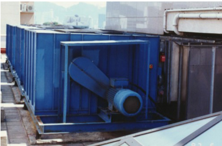
安裝在天台的油煙處理系統
