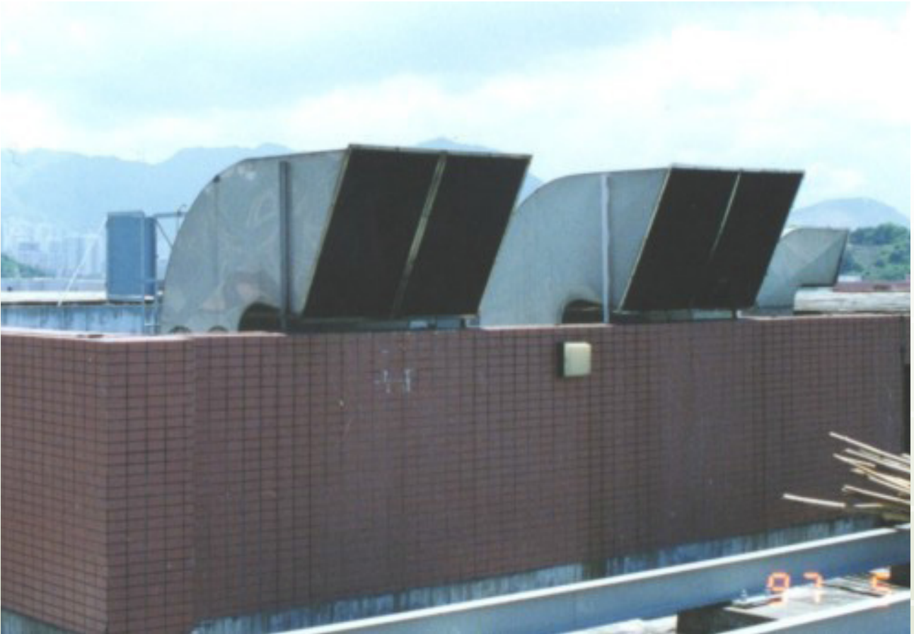
良好做法的例子——把廚房排氣口伸展至屋頂
