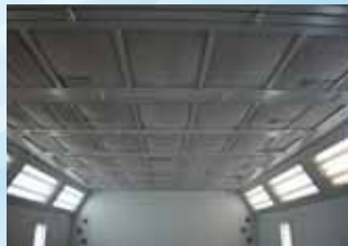
烤漆房內的抽風設備
