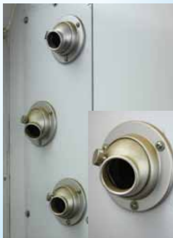
烤漆房吹風設備
