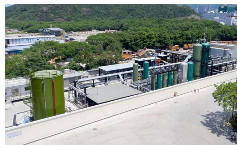
| 新界東南堆填區-堆填氣體發電設施
