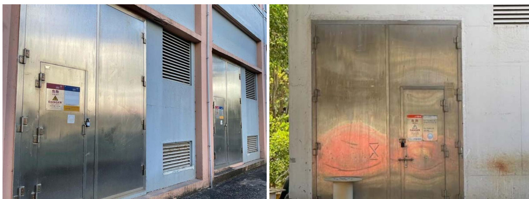
潛在土地污染熱點-設置變壓器的地方
