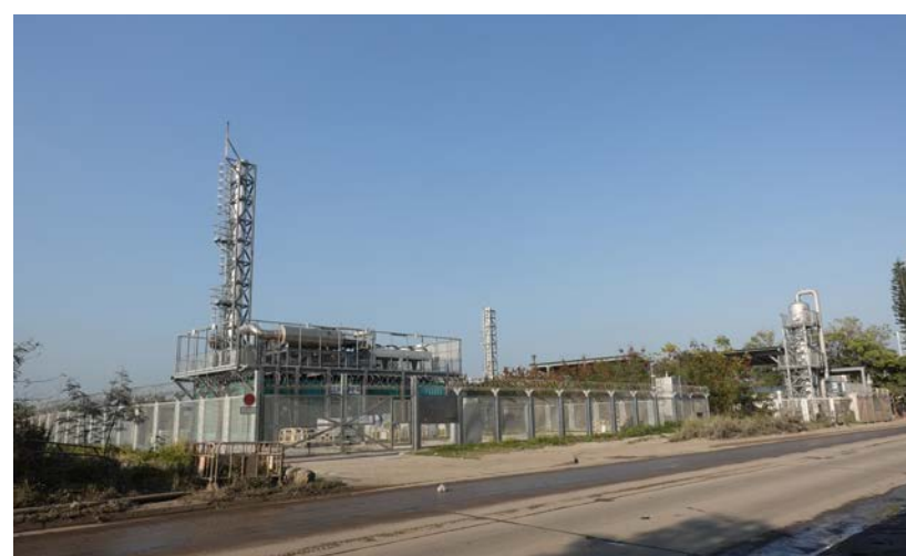
| 新界西堆填區的堆填氣體發電設施
