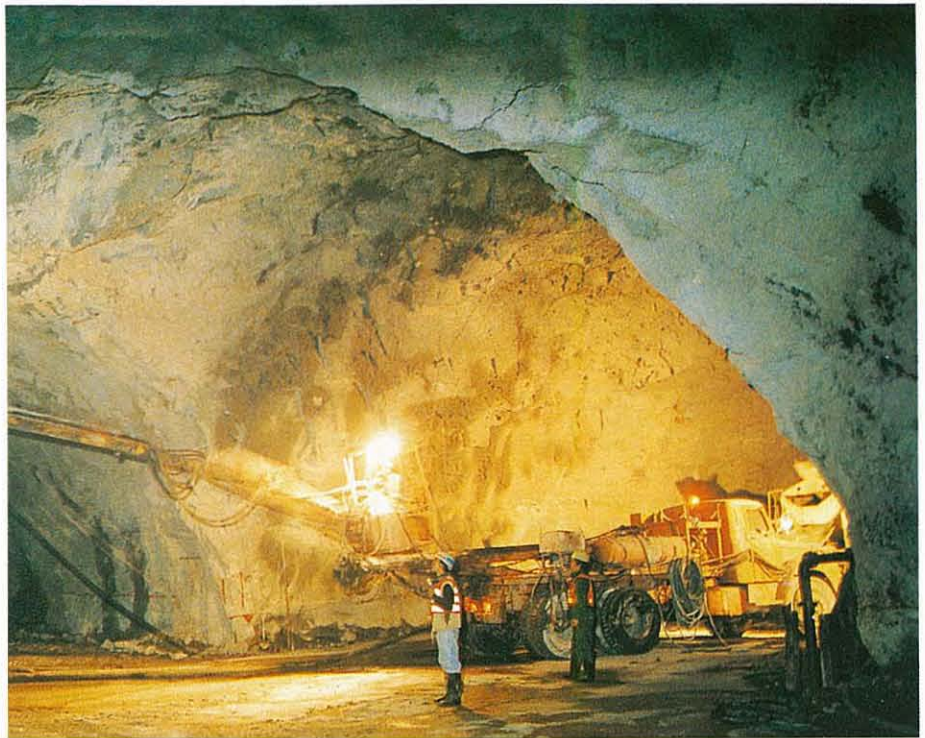
Early stages of Tate's Cairn tunnelling work. 早期工程中的大老山隧道。
