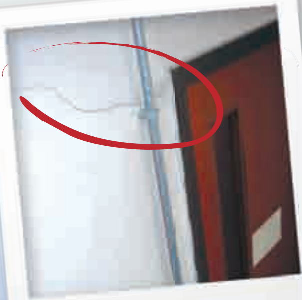
在門框角的裂縫
