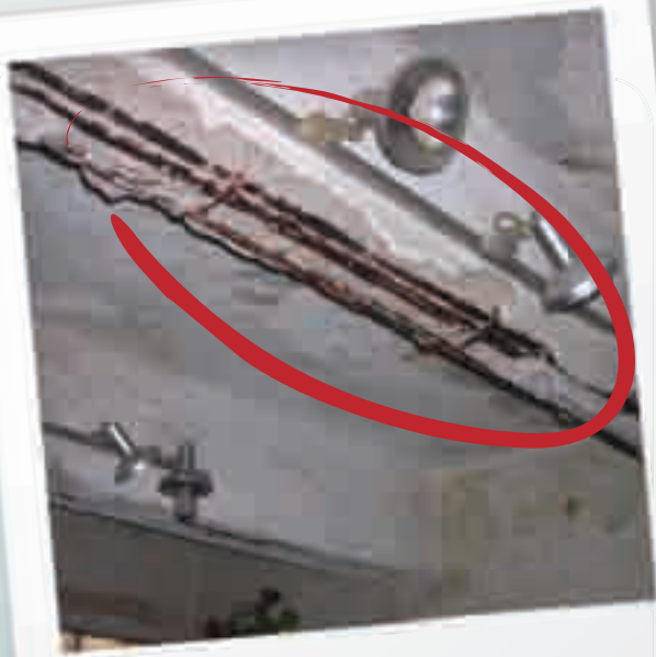
在橫樑底部的混凝土剝落
