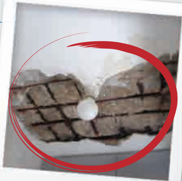
在天花的混凝土剥落
